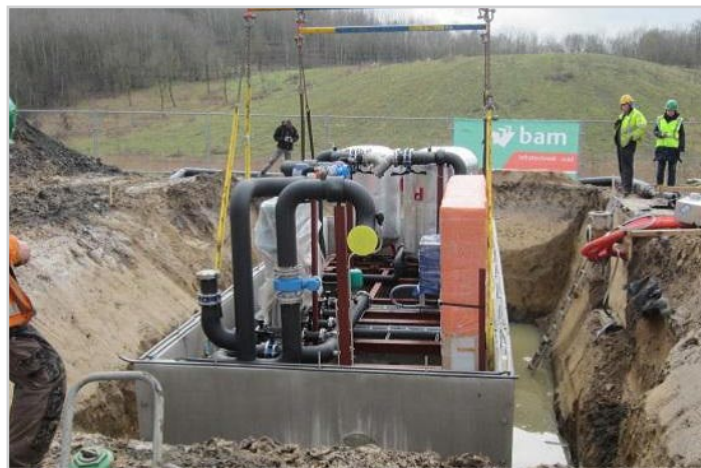
Zavedení zařízení na důlní vodu do výrobní studny
