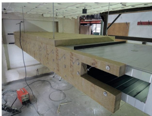
Obr. 66 Horní deska se nekotví přivařovacími trny, pouze se kotví požárními vrtů Fire Screw k boční desce
