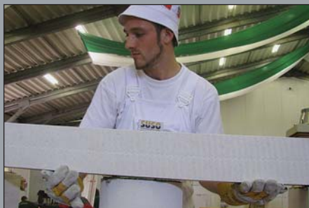
Správné uložení překladu.
