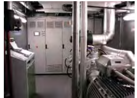
2 tepelná čerpadla v kontejneru mají každé výkon 1250 kW Foto Johnson Controls
