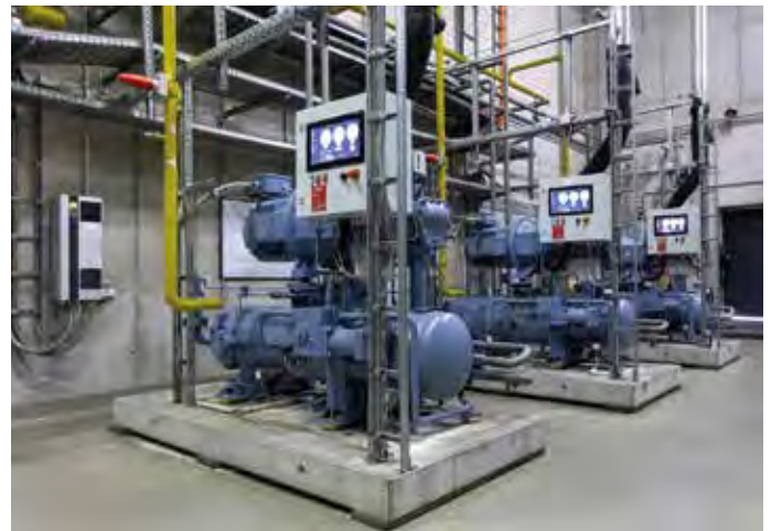
V Berlínské Aréně je instalována kaskáda \text{NH}_3/\text{CO}_2 . Chladicí kapalinou (chládonosným médiem) je \text{CO}_2 . \text{NH}_3 je chladivem v primárním okruhu. Hlavní součásti chladivového okruhu jsou kompresor, kondenzátor, škrticí prvek (vysokotlaký plovák) a výparník (zdroj chladu), čerpadla na chladivo a chladicí věž (Kühlturm). Foto: GEA/Cem Yüctetas
