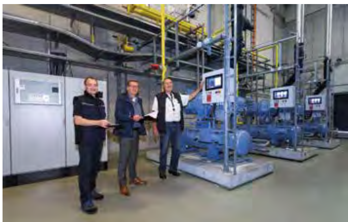
Martin Reichmuth, technický vedoucí servisu CLIMATIC GfKK - Gesellschaft für Kältechnik-Klimatechnik mbH, Matthias Wiegand, prodej GEA Compression Technologies, tepelná čerpadla a chladiče a Helge-Andreas Dietzsch, vedoucí technických služeb (zleva doprava) ve strojírně při kontrole zaregulování chladičích zařízení. Foto: GEA/Cem Yüctas
