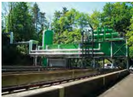
Kontejner se dvěma tepelnými čerpadly od Johnson Controls instalovanými nad sekundární usazovací (dočišťovací) nádrží Rheinfelden-Magden společnosti ARA Foto Johnson Controls
