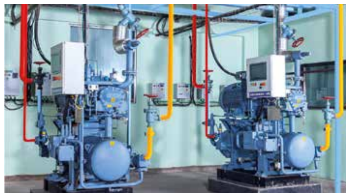
Inteligentní konstrukce kompresoru GEA Grasso řady M umožnila 15 až 20procentní zvýšení energetické účinnosti chladicího systému (Foto: GEA)
