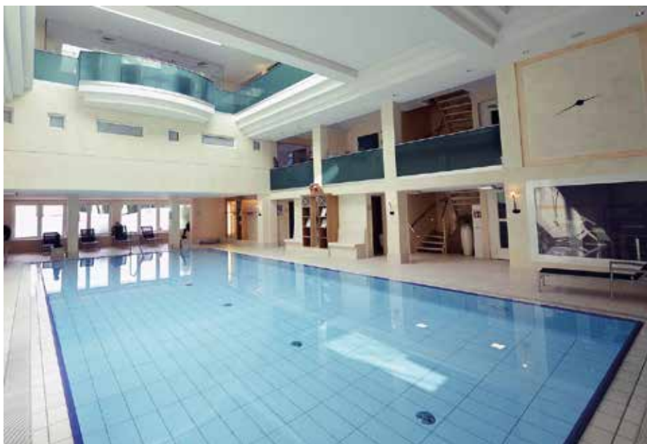
Přání zákazníka vytápět bazén rekuperací tepla bylo úspěšně zrealizováno.
