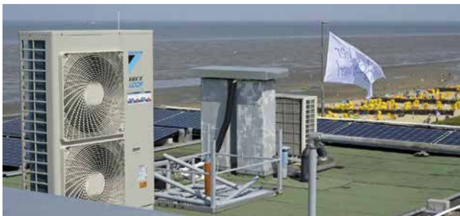
Venkovní jednotky Mini-VRV pro klimatizaci hotelových pokojů jsou umístěny na střeše hotelu. © Daikin
