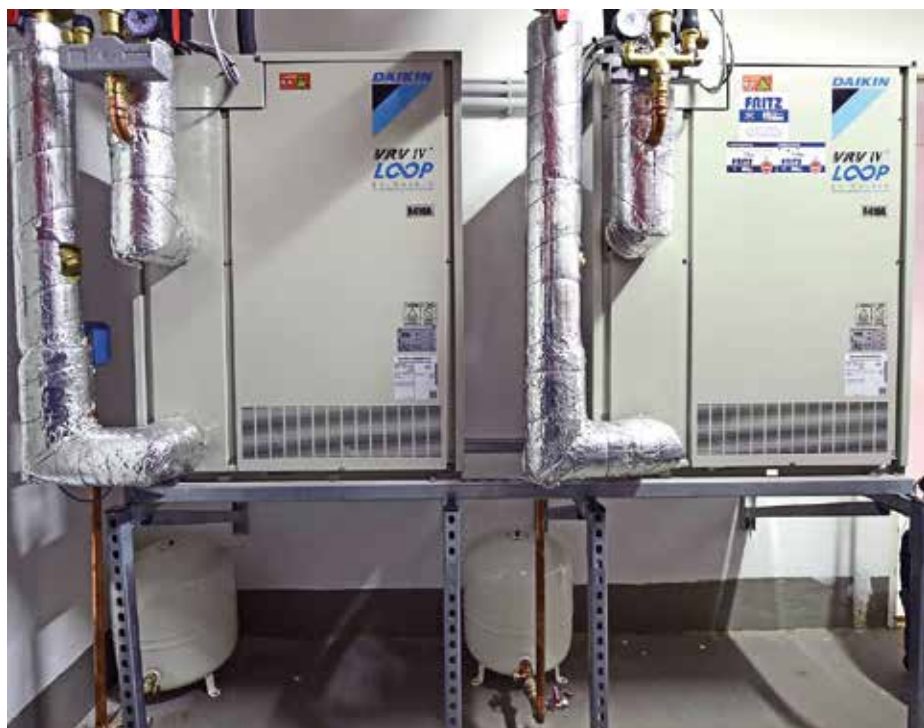
Tepelná čerpadla Daikin VRV IV používaná v hotelu jsou obzvláště šetrná k životnímu prostředí. Díky programu cirkulární ekonomiky L o P od společnosti Daikin se používá recyklované chladiivo. © Daikin
