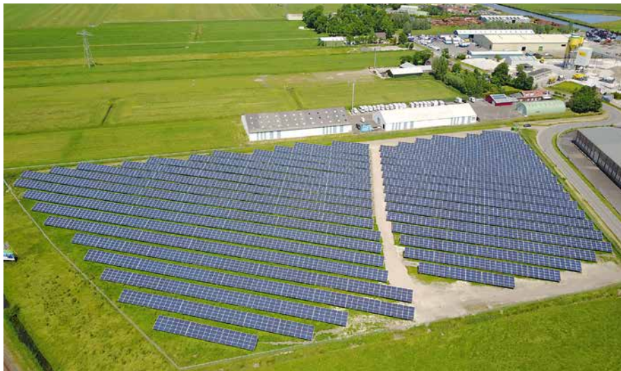
Solárny park Vierverlaten, Groningen, Holandsko
