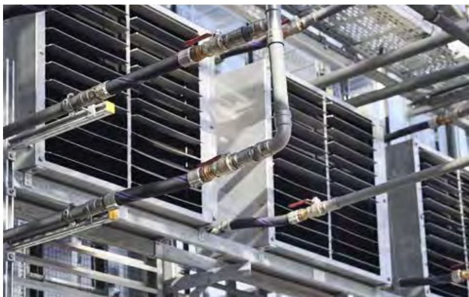
Flexibilní propojení otopných okruhů o halách a připojení k hlavnímu rozvodu slouží pro vyrovnání pohybů způsobených teplotními a mechanickými úlohy (foto: Viega)
