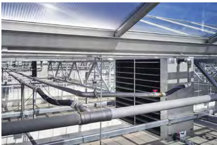
Obrovská pevnost ocelových trubek a lisovaných spojů Megapress umožňuje uložení potrubí s minimem pevných bodů pod stropem hal (foto: Viega)
