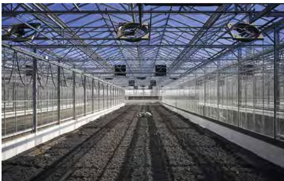
Některé haly na sušení čistírenských kalů, postavené jako skleníky, jsou dlouhé přes 160 m, v prostřední uličce dokonce přes 200 m (foto: Viega)
