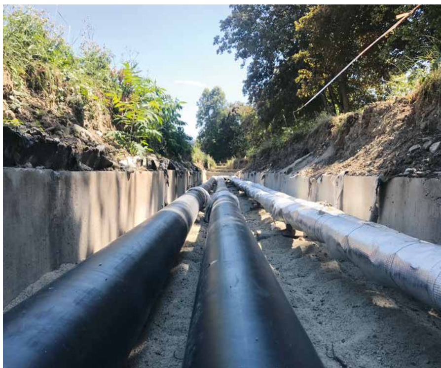
Obr. 3 Ukážka teplovodného kanála – dosluhujúce potrubie TV a cirkulácie a nové oceľové predizolované potrubie na trase realizovanej výmeny
