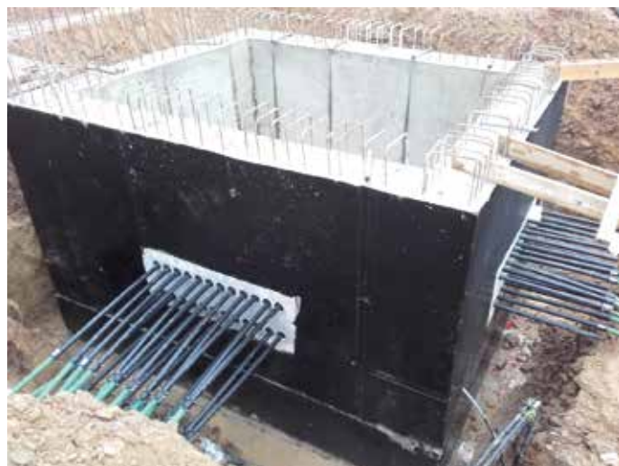
Podzemní monolitická sběrná jímka a celkem 48 trubek (2 x 24) o průměru d = 40 mm a dvojice systémových Multipažnic KRASO, které přesně navazují na rozteče rozdělovačů
