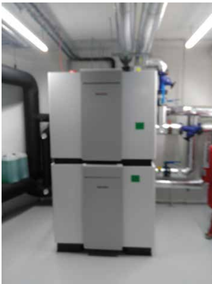
Kaskáda dvou tepelných čerpadel o součtovém topném výkonu cca 130 kW uložených na sobě ve strojovně vytápění a VZT ve 2.NP
