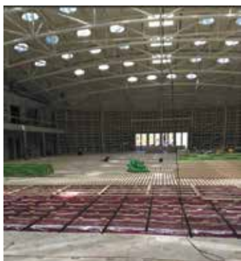
Pod pružnou podlahou sportovní haly je instalován systém podlahového vytápění a chlazení
