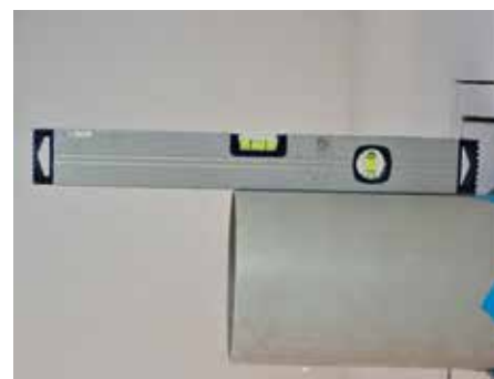
Obr. 15: Pohled v interiéru – trubka větrací jednotky musí mít předepsaný sklon směrem ven.
