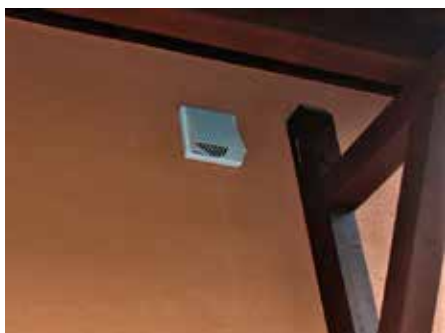
Obr. 19: Venkovní část větrací jednotky nijak neruší vzhled domu.
