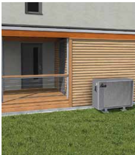
Venkovní jednotka tlačného reverzibilního tepelného čerpadla pro topení a chlazení včetně přípravy teplé vody
