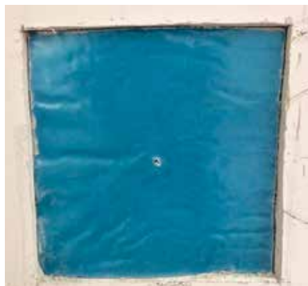
Obr. 7: Těsně pod sádrokartonem byla modrá fólie tvořící parotěsnou zábranu.
