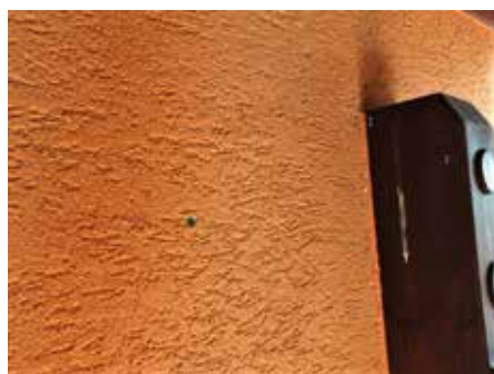
Obr. 6: Provrtání stěny na začátku ušetří mnoho problémů s pozdějším vyměřováním středu prostupu na fasádě.
