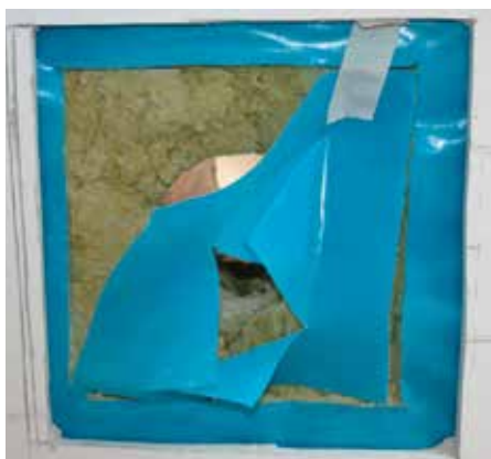
Obr. 11: Otvor v „interiérovém“ sádrokartonu po zvětšení za účelem získání přístupu k neporušeným okrajům parotěsné fólie.
