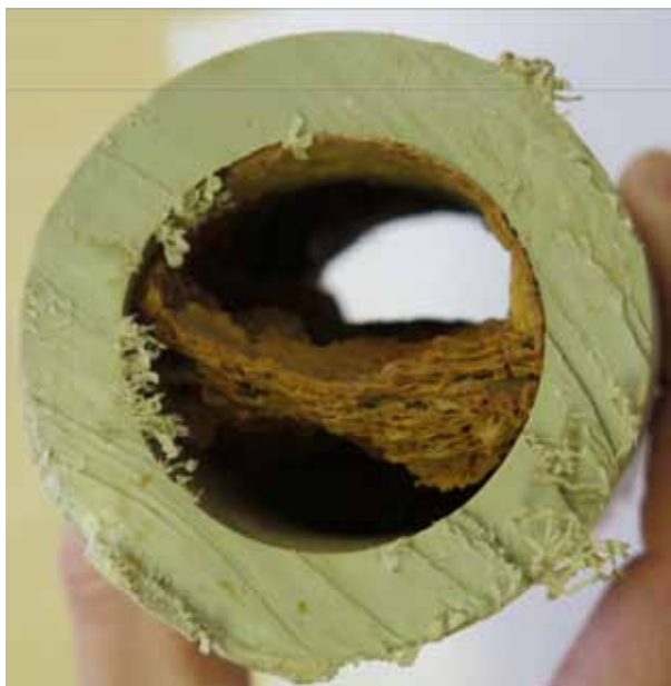
Obr. 2 Inkrustace v potrubí PPR
