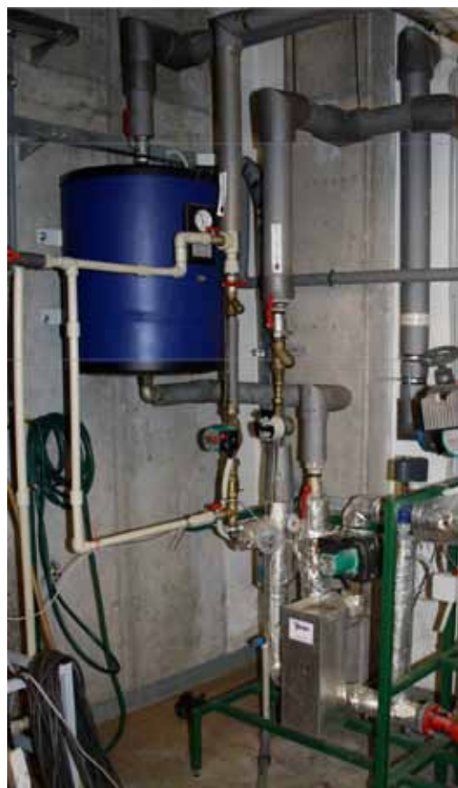
Obr. 5 „Boule“ na potrubí bez možnosti odkalování
