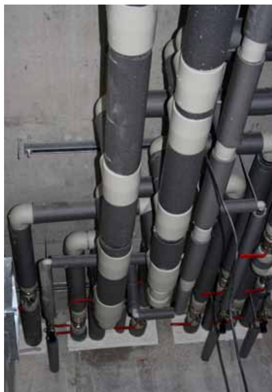
Obr. 1 Vadně provedená tepelná izolace. Katalogový list výrobce neobsahuje údaj o teplotě továrního nastavení armatury (stav k 30. 11. 2016)
