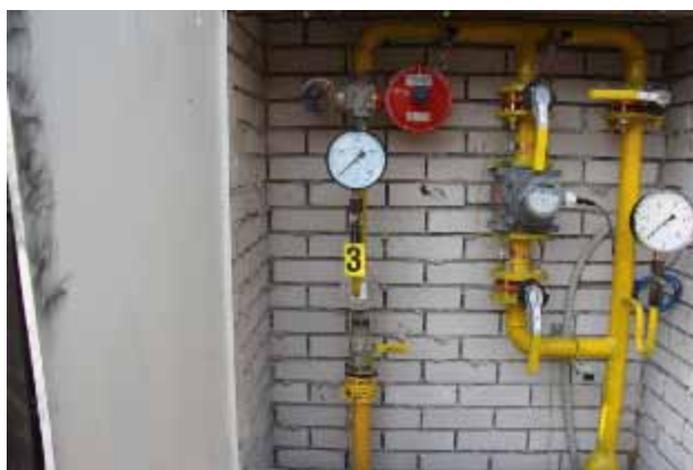
Obr. 8 Pohled na plynové zařízení ve skříni
