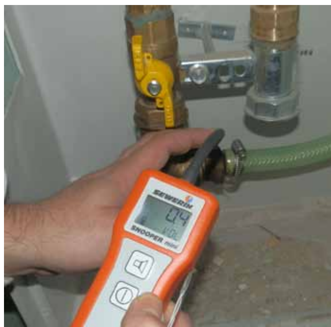
Obr. 11 Pohled na místo se zjištěným únikem plynu
