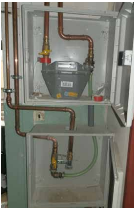
Obr. 9 Celkový pohled na plynovou instalaci s provedeným nedovoleným zásahem
