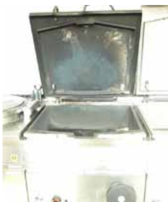
Obr.1 Celkový pohled na plynový spotřebič s otevřeným poklopem
