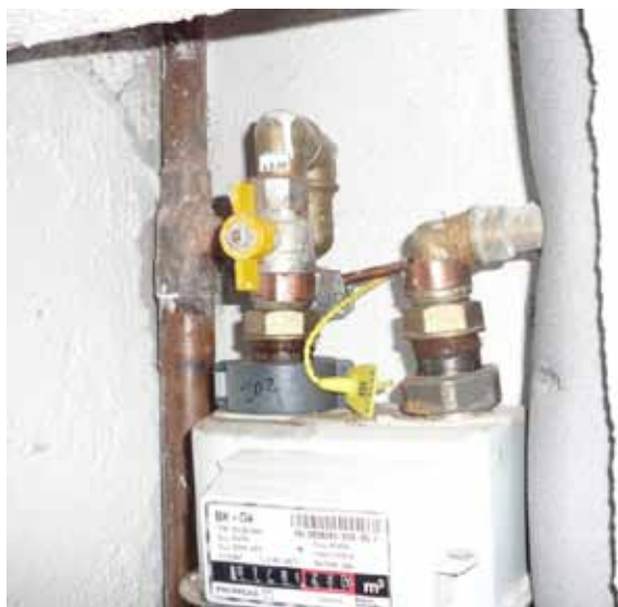
Obr. 12 V místě pravého šroubení plynoměru je patrné silné mechanické namáhání, kde později došlo k destrukci materiálu a úniku plynu
