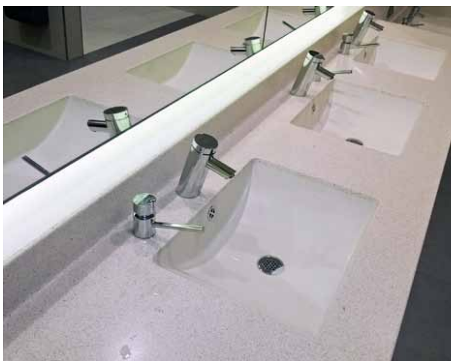
Nové armatury Schell Puris SC-M na záchodech Nákupního centra Metropole Zličín
