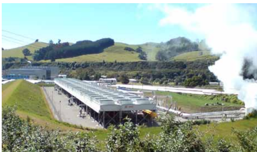
Geotermální elektrárna Wairakei s osmi turbínami o výkonu 170 MWe kryje 10 % spotřeby elektřiny Nového Zélandu
