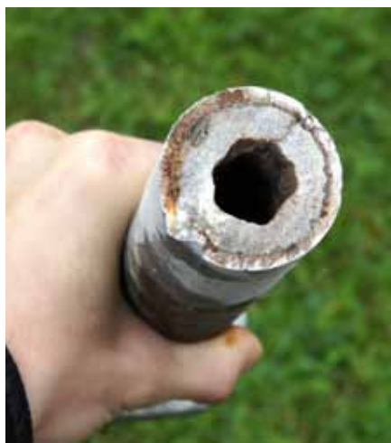
Stav starých trubek před sanací
