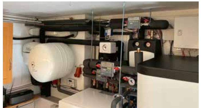
Teplné čerpadlo v kotelně
