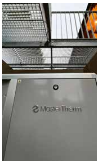
Umístění jednotky pod schody
