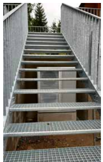
Umístění jednotky pod schody
