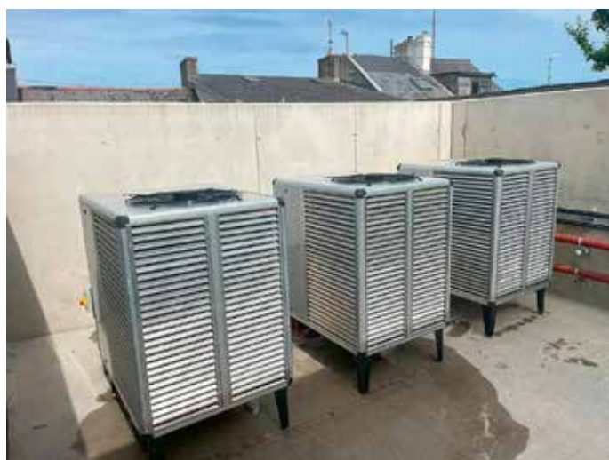
Kaskáda tepelných čerpadel pro azylový dům
