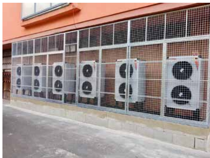
Venkovní jednotky jsou umístěny podle venkovní zdi objektu na betonovém základě s odvodem kondenzátu a vloženým topným kabelem v drenážním záspy
