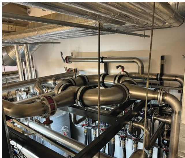
Obr. 5 Realizovaný stav – pohled na hydraulický věnec DN 200 z nerezových oblouků a redukovanými T-kusy [1].
