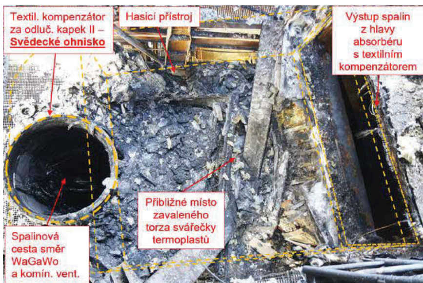
Obr. 4 Pohled na trosky odlučovače kapek II z výškové úrovně 26 m
