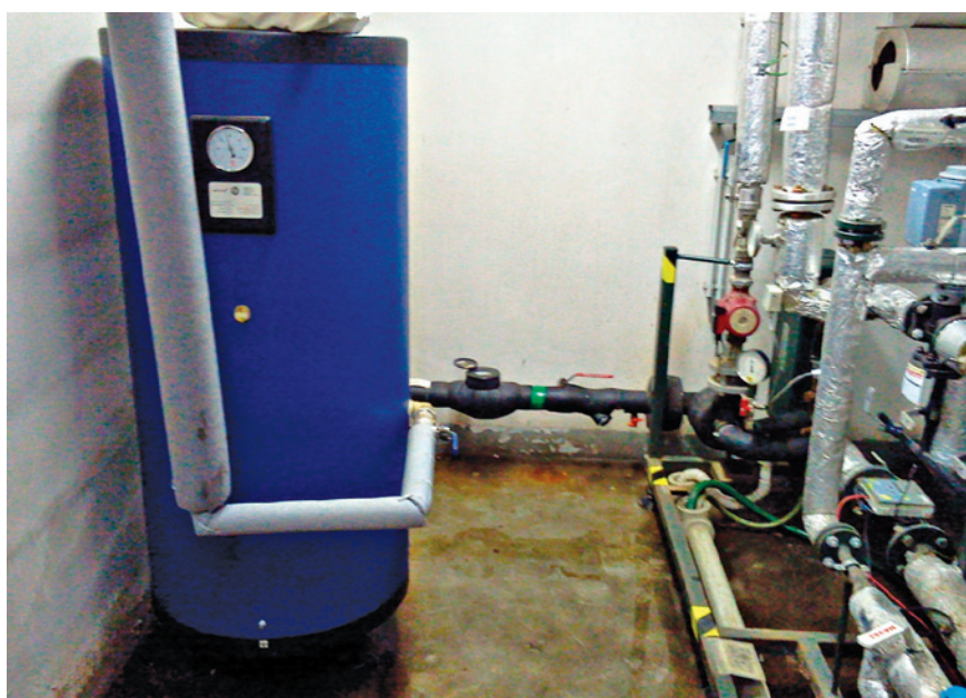
Obr. 1 Pohled do výměňkové stanice; vpravo průtokový ohřivač vody (deskový výměník) a cirkulační čerpadlo, vlevo stojatý zásobník teplé vody
