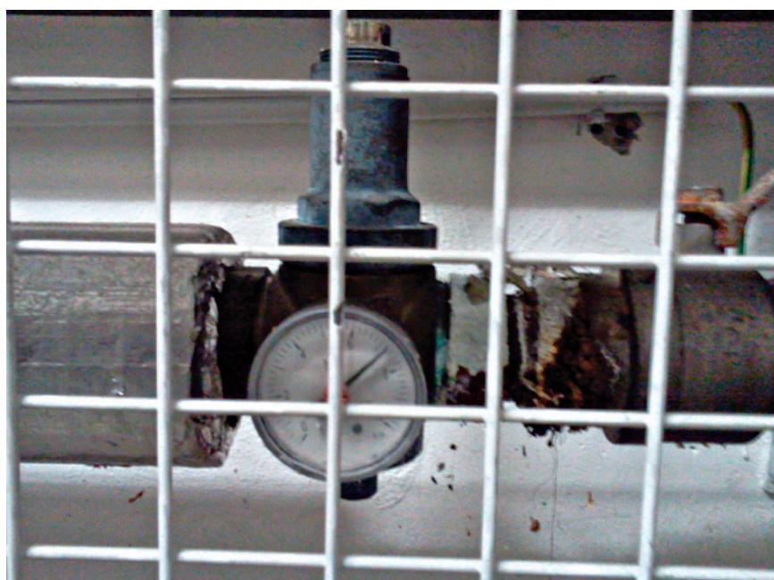
Obr. 3 Redukční ventil osazený původně na přívodu studené vody do jednotlivé sekce domu
