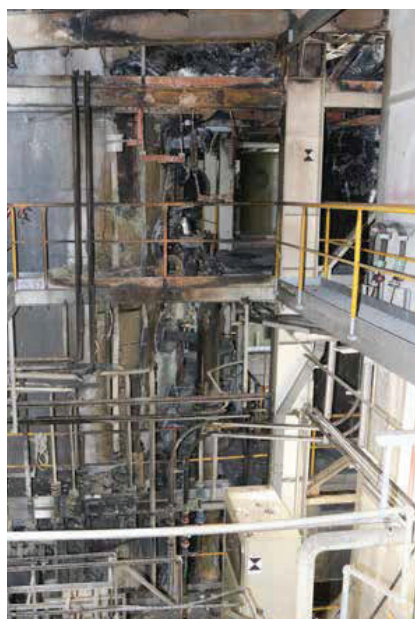
Obr. 3 Pohled na stopy šíření požáru na absorbérů linky L3
