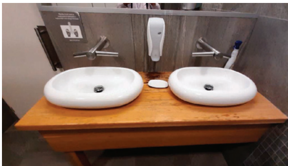
Obr. 1 Umyvadla na dřevěné desce
