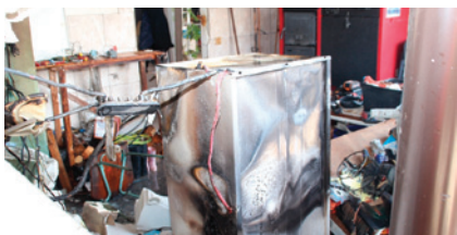
Pohled na požární ohnisko skrz chybějící obvodovou zeď
