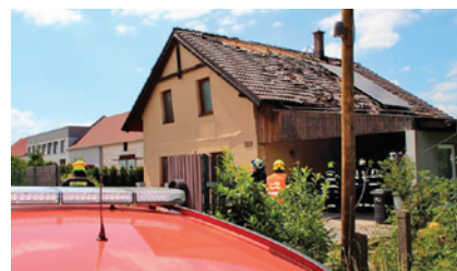
Pohled na severní stranu objektu (střeša s FVE panely)
