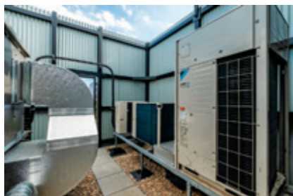
VRV 5 HR a vnější jednotky splitové klimatizace Daikin na střeše objektu
