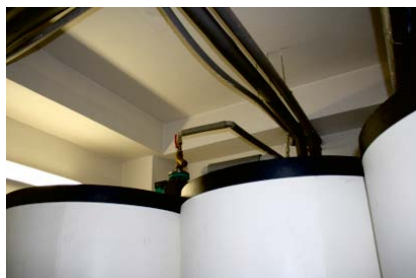
Obr. 4 Dodatečné připojení zásobníků teplé vody
