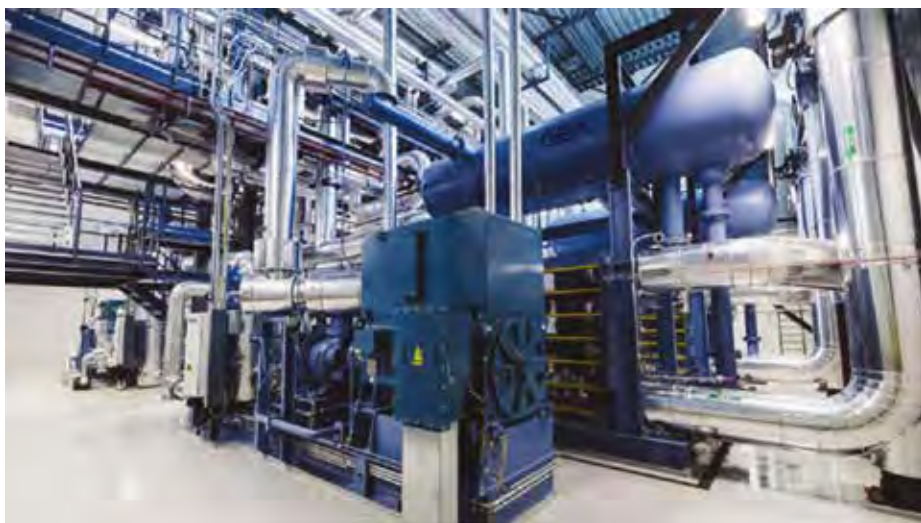
Systém tepelných čerpadel GEA v energetickém komplexu Utilitas Vao v estonském hlavním městě Tallinnu (Foto: GEA)
