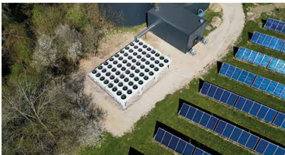
Velké tepelné čerpadlo se čtyřmi blokovými suchými výparníky, každý má 18 ventilátorových jednotek, v lokalitě Havdrup vedle stávajícího solárního systému (Großwärmepumpe in Havdrup neben bestehender Solarthermieanlage)
