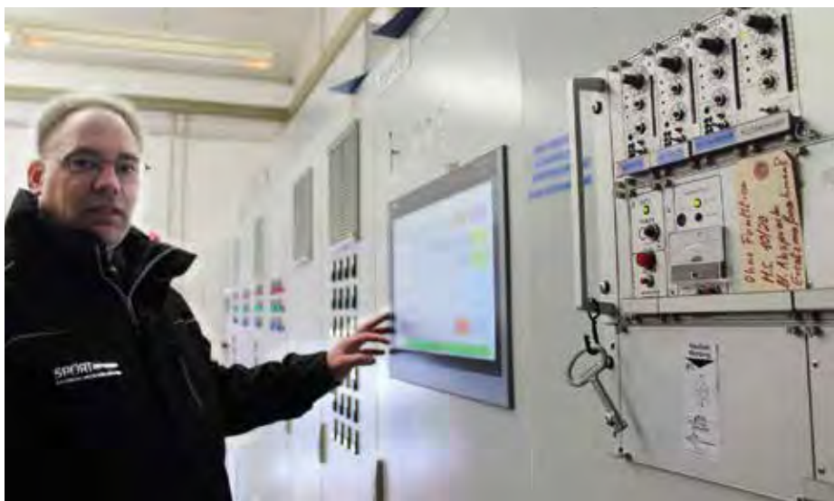
Manažer Veltins-EisArena Stefan Knipschild před řídicím systémem ve strojovně chladičích systému ve Winterbergu (Foto: GEA)
