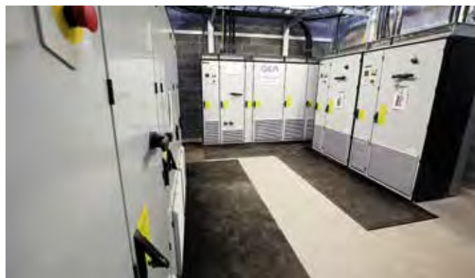
Technické centrum s rozvaděči.
