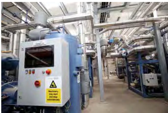
Použití čpavkových tepelných čerpadel v projektu Gateshead představuje pokrok ve vývoji dálkového vytápění. (Foto: GEA)
