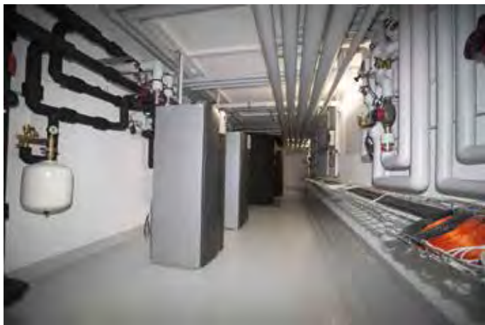
Kotelna/strojovna s tepelným čerpadlem a akumulátorem tepla © alpha innotec
