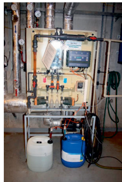
Obr. 5 Generátor chloru dioxidu
