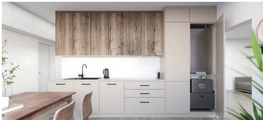
Ukázka soustavy s elektrokotlem ENBRA DROVEN MINI ukryté v nábytkové skříni
