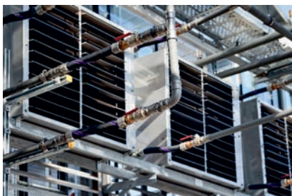
Flexibilní propojení otopných okruhů v halách a připojení k hlavnímu rozvodu slouží pro vyrovnání pohybu způsobených tepelnými a mechanickými vlivy. (foto: Viega)
