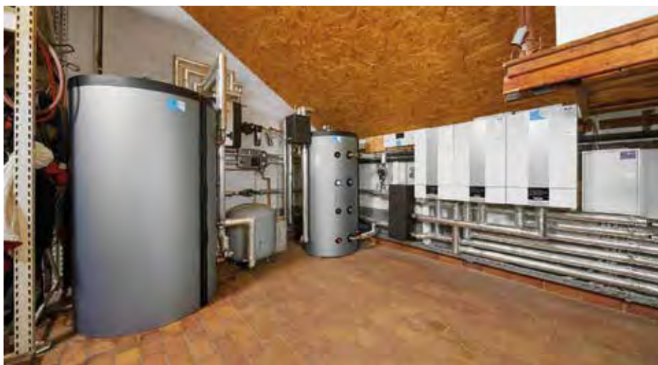
Kaskáda monoblokových tepelných čerpadel Wolf CHA se skládá ze tří zařízení, každé o topném výkonu 10 kW, vpravo na zdi tři unitní jednotky © Wolf
