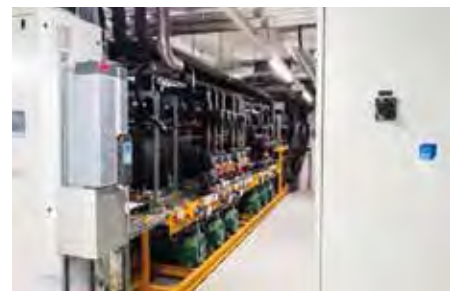
Migros Surseepark: Pohled do strojovny chlazení (Kältezentrale) © Frigo Consult
