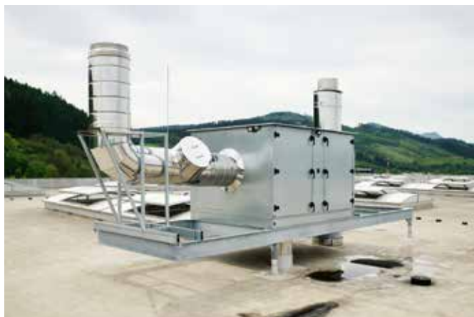
Obr. 2 Inštalácia systému rekuperácie tepla vo vnútornom prostredí – Slovensko
