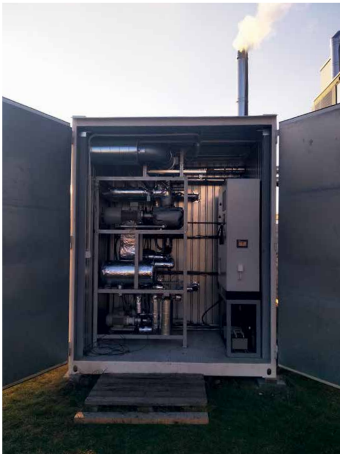
Pohľad na ORC časť zariadenia
