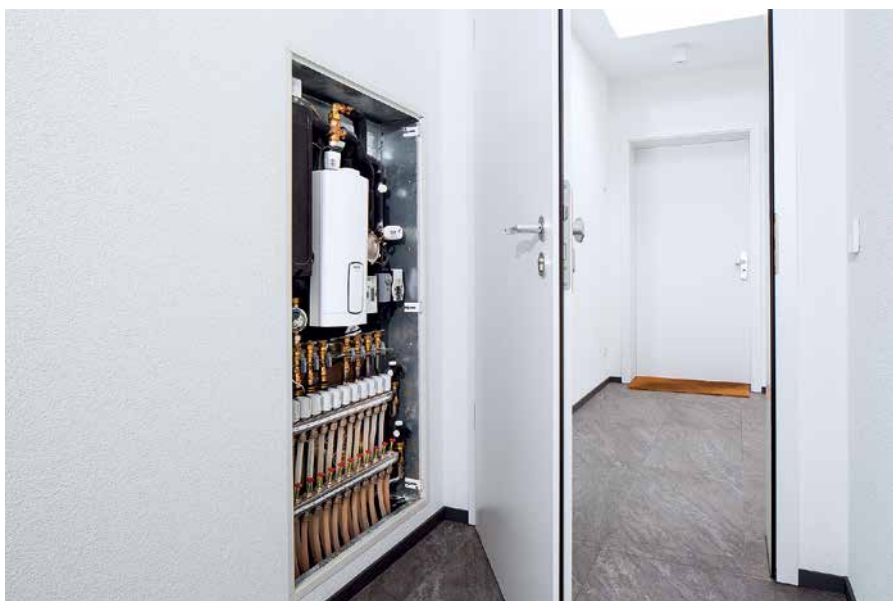
Vysoký užívateľský komfort zabezpečujú v jednotlivých bytoch bytové stanice.
