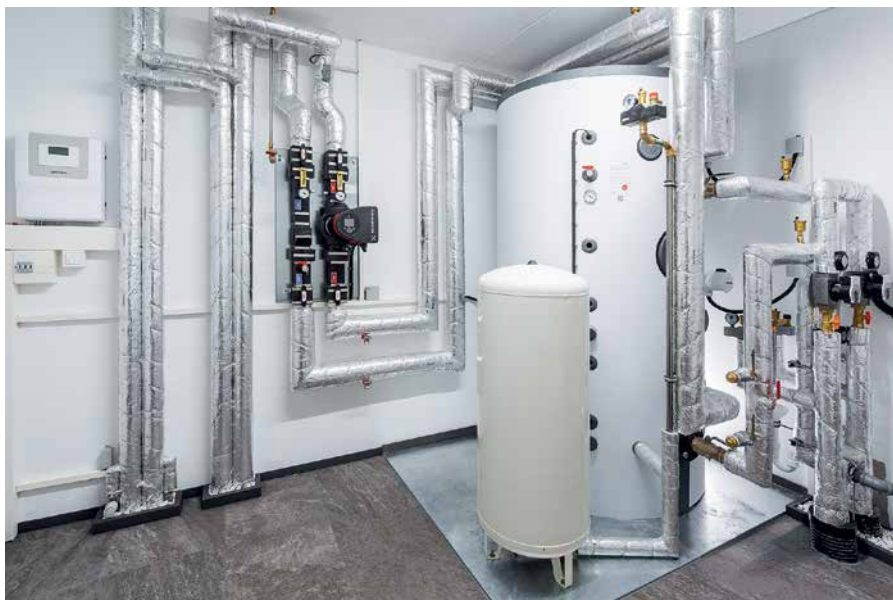
V technickej miestnosti sa nachádza regulácia tepelných čerpadiel a stacionárny 1 500-litrový akumulčný zásobník.
