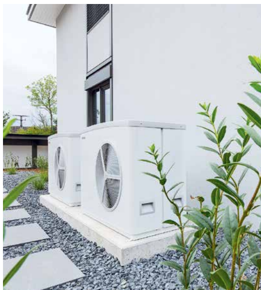
Tepelné čerpadlá vzduch – voda sú umiestnené v exteriéri v blízkosti technickej miestnosti situovanej na prízemí.
