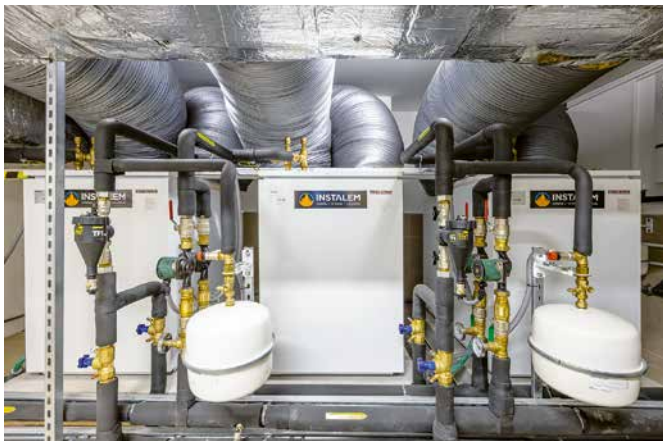
Kaskádový systém troch interiérových jednotiek tepelného čerpadla STIEBEL ELTRON WPL 24 I typu vzduch – voda
