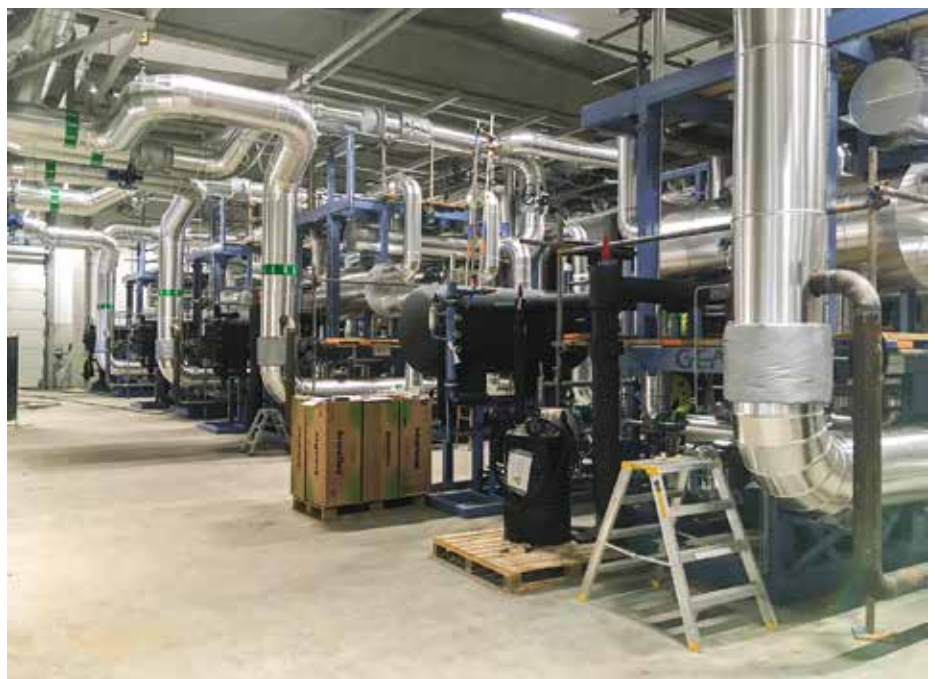
Obr. 1: Čpavková tepelná čerpadla instalovaná v Malmö
