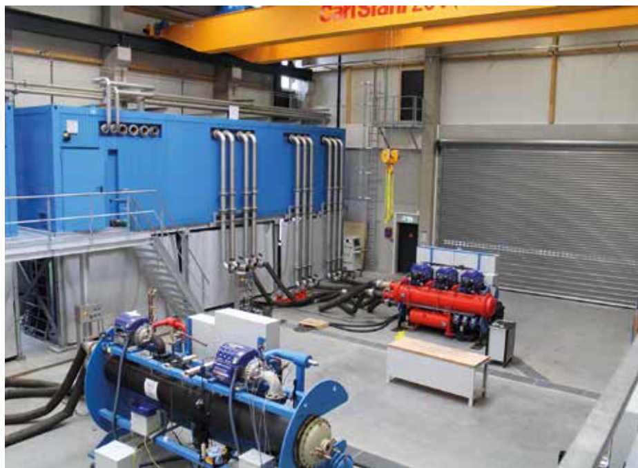
Vnitřní zkušebna (Innenprüfstand) společnosti ENGIE Refrigeration
