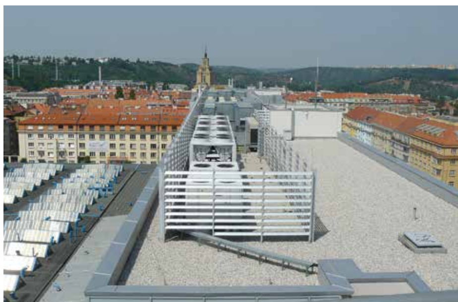
Venkovní jednotky VRV a před nimi chillery na střeše budovy B, v pozadí vyčnívá věž hotelu, který se dlouhá léta jmenoval Internacionál Foto Václav Nosek
