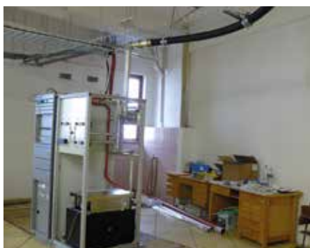
Jedna z poloprázdných místností, dřívě plná techniky nutné pro zajištění digitálního vysílání Foto Václav Nosek
