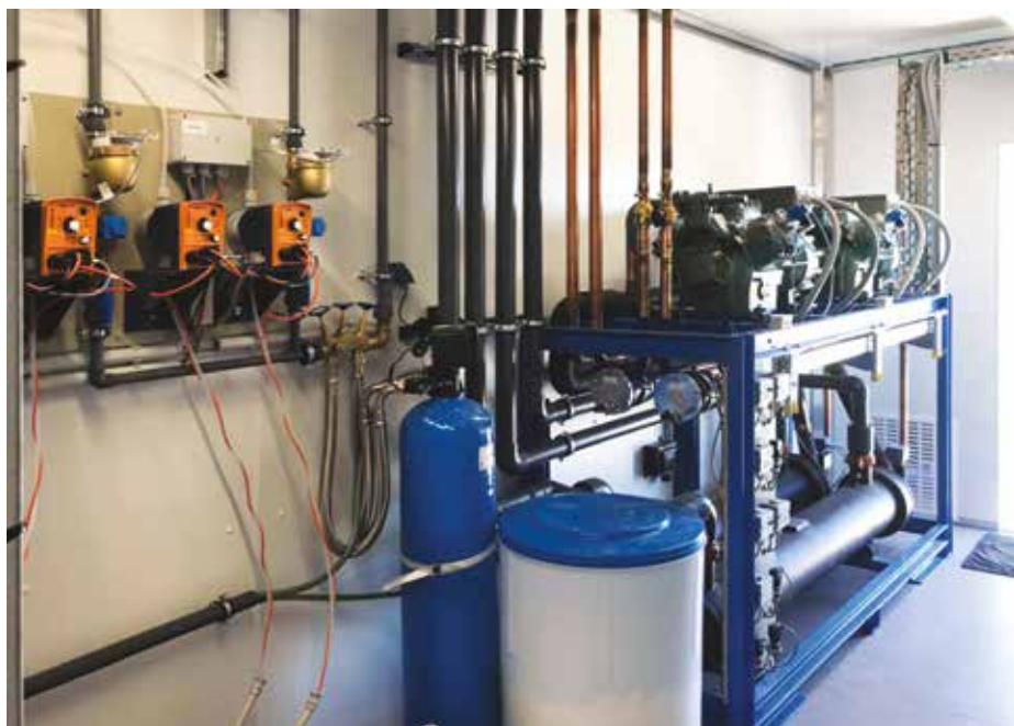
Při navrhování chladicího systému se Reisner spolehl na dvojitý systém se dvěma výkonově regulovanými pístovými kompresory BITZER, každý s chladicí kapacitou 96 kW
