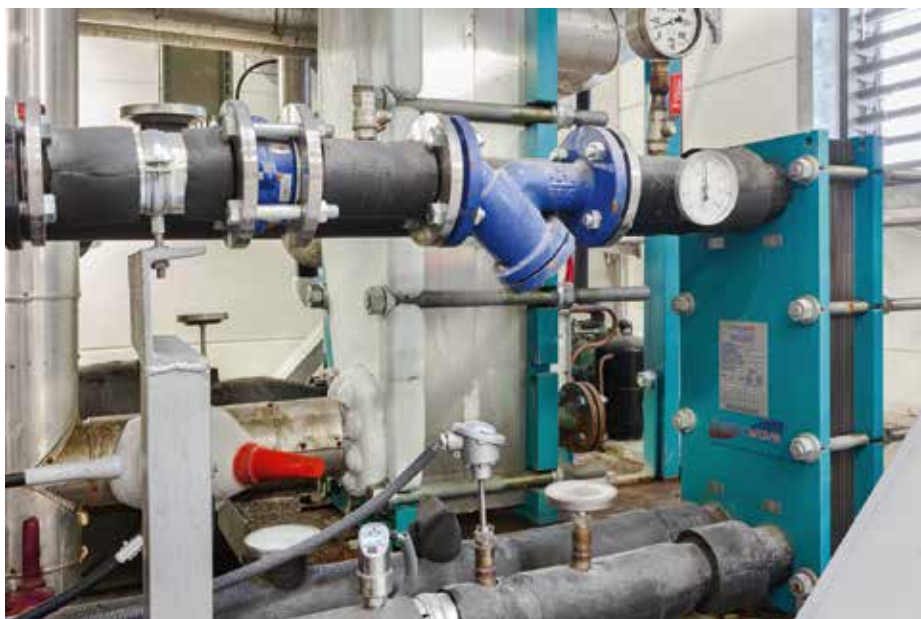
Vysoce výkonný čpavkový deskový výparník thermowave (v pozadí) chladí okruh glykolu (Glykolkreislauf), který distribuuje chlad k chladičům vzduchu a další deskový výměník thermowave (v popředí) zásobuje centrální větrací zařízení (zentrale Lüftungsanlage) pro kanceláře / Foto Güntner (Gt_TK_Backwaren_333)
