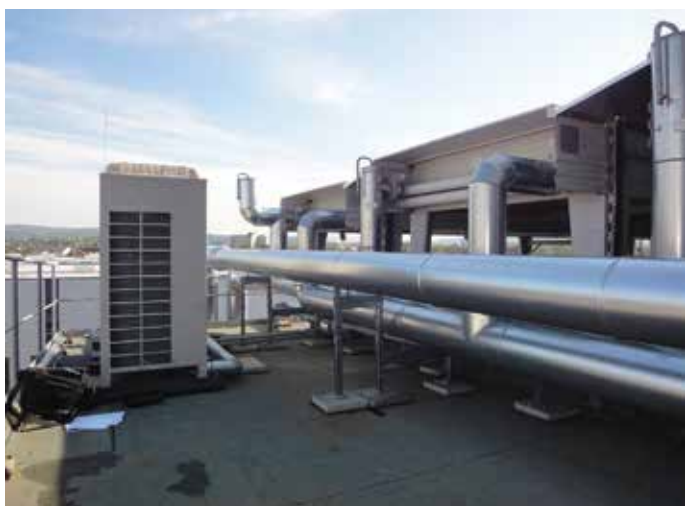
Obr. 2: Především u sanačních projektů v centrech měst (bei innerstädtischen Sanierungsprojekten) bývá nabídka místa, které je na střeše k dispozici, velmi omezená a navíc potrubí a jiné nástavby brání volnému proudění vzduchu k výměníku (Abb2_DSC03935.jpg)
