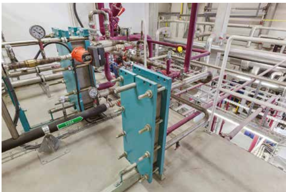
Odpadní teplo (Abwärme) z čpavkového výparníku ( \text{NH}_3 -Verdampfer) je dvěma deskovými výměníky thermowave – chladiči přehřáté páry (Enthitzer; jedná se o teplo, které je nutno odvést ze zkomprimovaných par chladiwa za kompresorem – poznámka redakce ) předáváno do dvou sekundárních okruhů s glykolem a je využito jak k vytápění kanceláří, tak i základů, aby podloží skladu nepřezamrzlo a zabránilo se tak poškození základové desky / Foto Güntner (Gt_TK_Backwaren_345)
