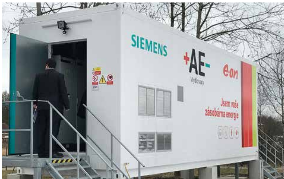
V Mydlovarech je celé řešení nainstalováno do kontejneru, čímž se minimalizovaly jak náklady na stavební část tak i montážní práce v místě realizace. SIESTORAGE je navíc možné snadno integrovat do stávajících systémů díky ušlechtilému řídicímu systému a vyspělým technologiím.
