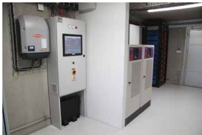
Vybavení nabíjecí stanice PRE v Holešovicích
