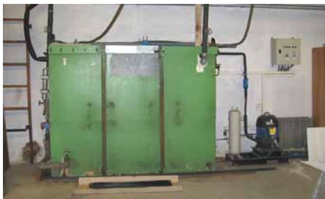
Obr. 9 ZL TZB – Zásobní nádrž chladicí vody s kompresorem
