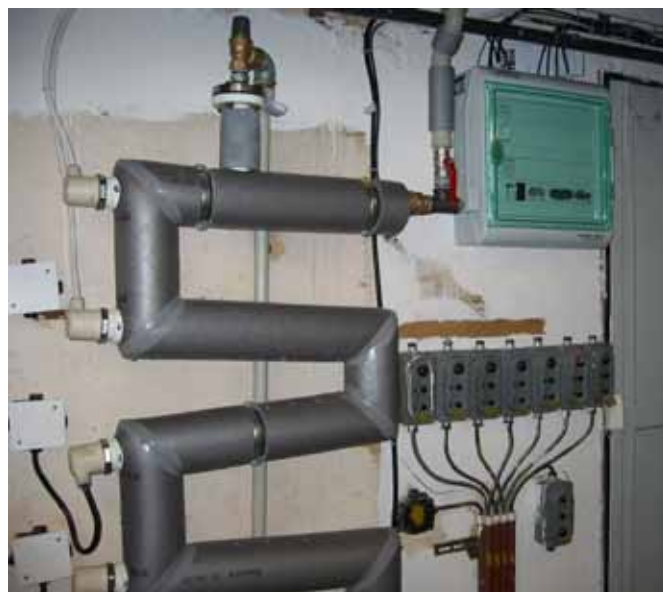
Obr. 8 ZL TZB – ohřívák zkušební vody
