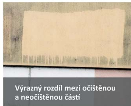
Šetrný způsob čištění a ošetření zarostlé fasády
