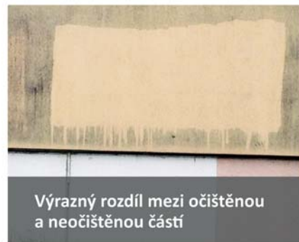
Šetrný způsob čištění a ošetření zarostlé fasády
