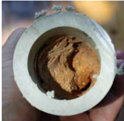
Obr. 5 Inkrustace v plastovém potrubí
