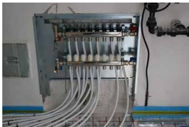
Osminásobný rozdělovač umístěný ve skřínce pod omítku
