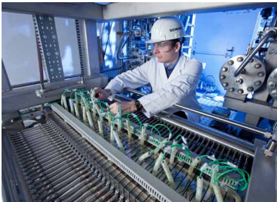
Inženýři společnosti Siemens vyvinuli elektrolyzátor založený na výměně protonů s reakční dobou v řádech milisekund. Je tedy vhodný pro nestabilní toky elektrické energie
