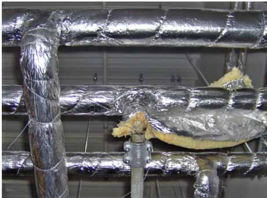
Obr. 8 „Cípant“ na ocelovém pozinkovaném potrubí
