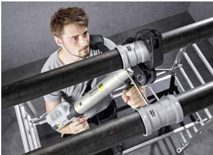
Silnostěnné ocelové trubky o rozměrech 2½ až 4 palce je možno snadno lisovat tvarovkami Megapress S XL za pomoci nástroje Pressgun Press Booster od společnosti Viega. Touto metodou se uspoří oproti tradičnímu svařování až 80 % času (foto: Viega)
