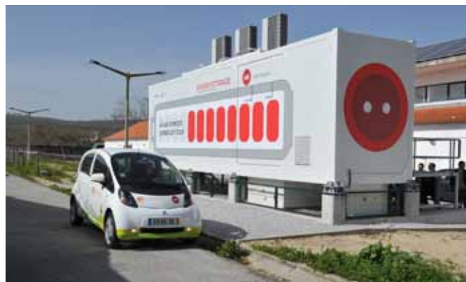
Instalace SIESTORAGE v portugalské Évora
