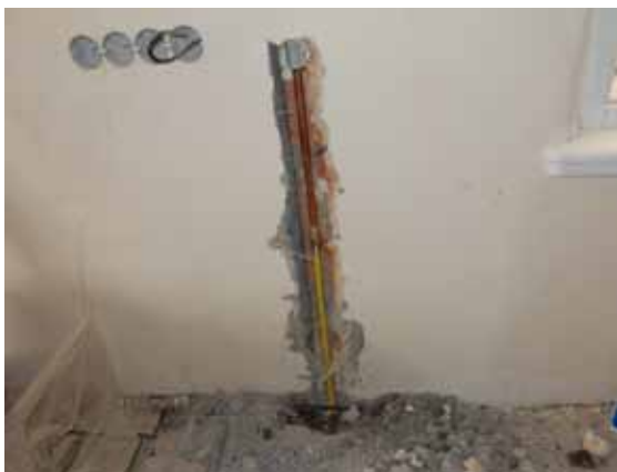
Obr. 1 Celkový pohled na místo úniku plynu
