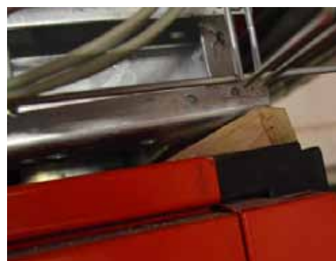
Obr. 3 Ukázka nekvalitní montáže, spojování komor a jejich rovinatost – vyklínování komory
