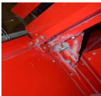
Obr. 4 Ukázka nekvalitní montáže, spojování komor – následné dotěsnění silikonem špatně přisazených komor a jejich spojů
