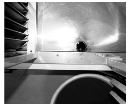
Obr. 2 Boční výtok kondenzátu včetně stojící kapaliny v místě odtoku (tzv. nezapuštěná vana vlevo) a zapuštěný výtok při boční straně vany na kondenzát při pohledu shora (vpravo)
