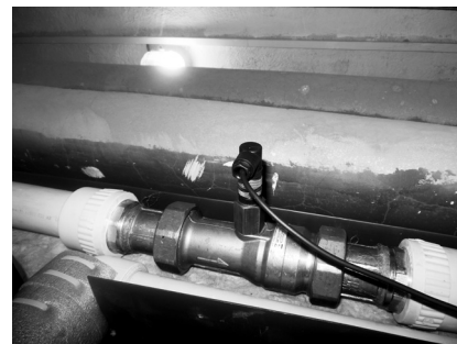
Obrázek 2 – Průtokoměr VT 4025 MSHNS000F osazený na hlavním přívodním potrubí teplé vody bytového domu v Brně
