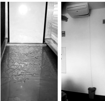
Obr. 1 Ukázka stojící a neodtékáající vody z komory chlazení ve vzduchotechnické jednotce (vlevo), nesprávně provedený odvod kondenzátu od výparníku klimatizace (vpravo)
