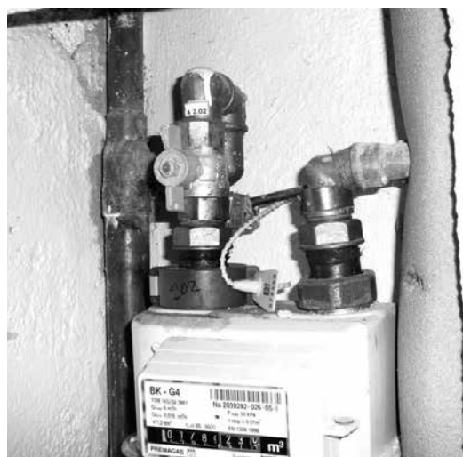
Obr. 1 V místě pravého šroubení plynoměru je patrné silné mechanické namáhání, kde později došlo k destrukci materiálu a úniku plynu
