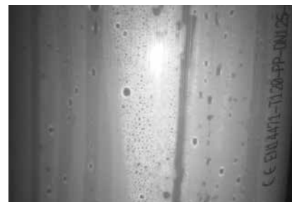
b) detail s kapkami kondenzátu a stopami po stékajícím kondenzátu na vnitřní stěně
