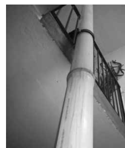
Obr. 1 Průhledný plastový odvod spalin od plynového kotle
