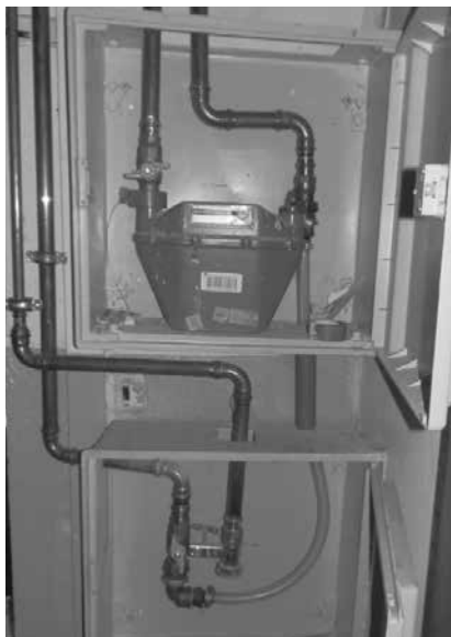
Obr. 1: Celkový pohled na plynovou instalaci s provedeným nedovoleným zásahem
