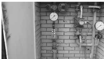
Obr. 2: Pohled na plynové zařízení ve skříňce
