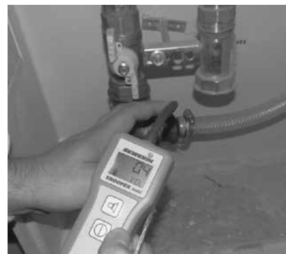
Obr. 3: Pohled na místo se zjištěným únikem plynu
