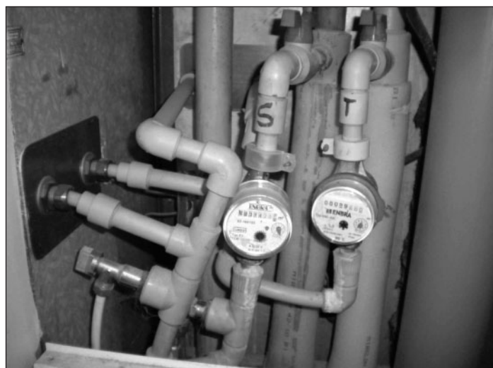
Obr. 3 Vadná instalace potrubí, pokles o cca 70 mm (3 roky v provozu)
