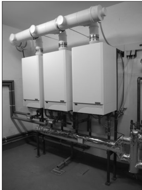
Kaskádová kotelna Thermona z kondenzačních kotlů Therm 45 KD o výkonu 135 kW (Studénka).
