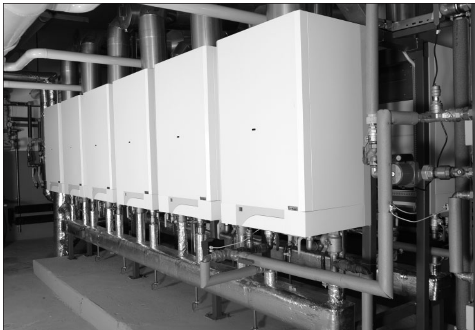
Kaskádová kotelna Thermona ze závěsných kotlů Therm TRIO 90 (Rosice u Brna).
