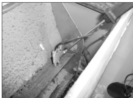
Obr. 7 Detailní pohled na částečně očištěné čidlo pojistky zpětného toku spalin pro účely měření doby reakce k odstavení kotle z provozu.
