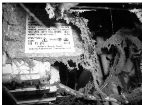
Obr. 4 Detailní pohled na znečištění plynového kotle.
