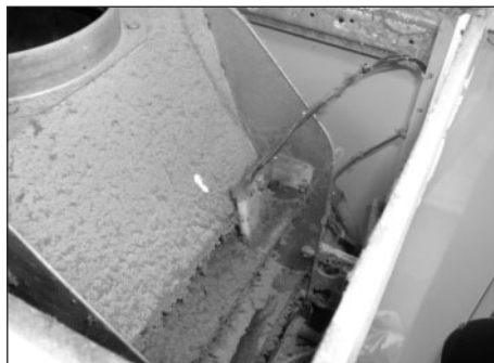
Obr. 6 Detailní pohled na instalované čidlo pojistky zpětného toku spalin se známými značkami značného znečištění včetně silných úsad nečistot v celém okolí.
