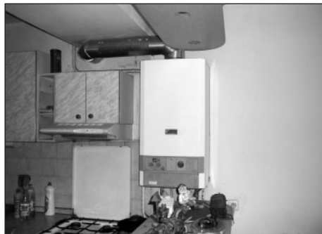
Obr. 1 Celkový pohled na instalovaný plynový kotel.
