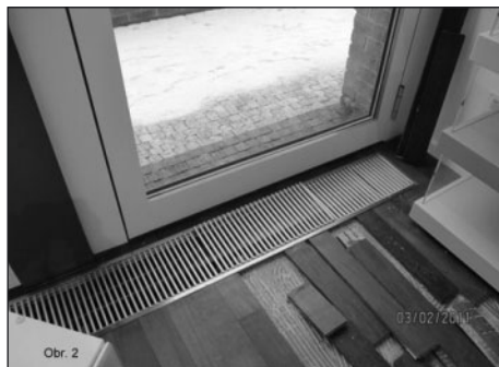
Obr. 2 – Poškozená parketová podlaha vodou z vytápěcí soustavy.
