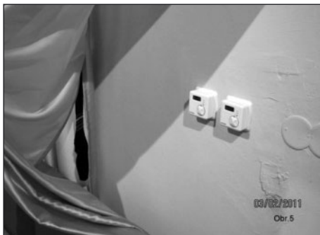
Obr. 5 - Umístění termostatů řídících funkci podlahových ventilátorů.
